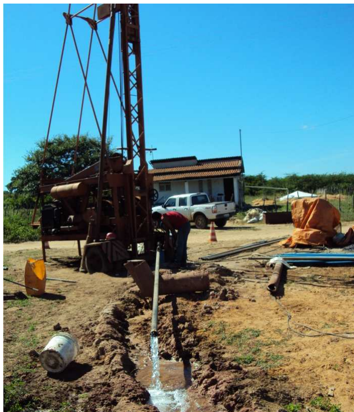
Bombeamento de poço tubular no assentamento Língua de Vaca, do município de Ipangaçu
