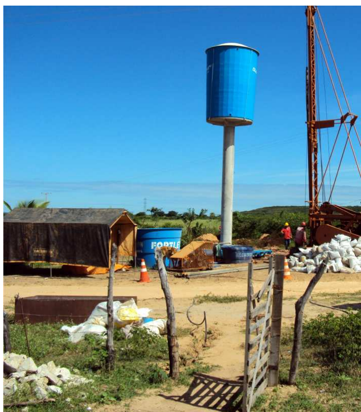
Caixa d'água instalada e sonda percussora no local do poço na agrovila Canto Claro, no município de Ipangaçu
