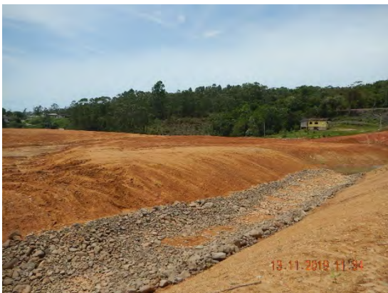
Obra de drenagem das águas pluviais e cobertura de argila implantada sobre os estêreis de cobertura.
